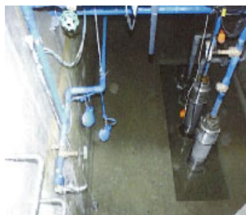
◀地下に設けられた雨水槽
